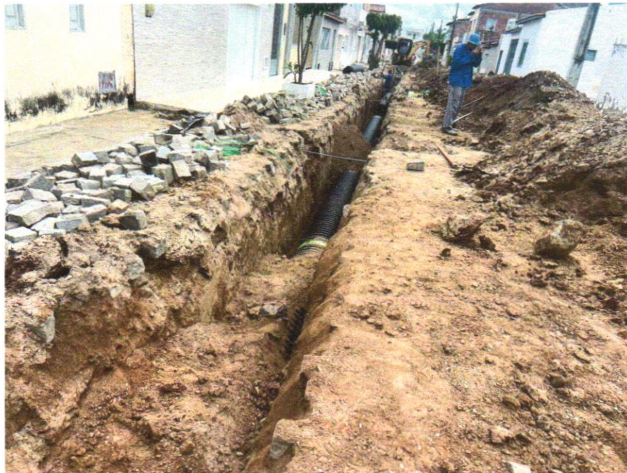
Foto 13 - FORNECIMENTO E ASSENTAMENTO DE TUBO CORRUGADO PAREDE DUPLA PEAD, D = 600 MM (24"), PARA SISTEMAS DRENAGEM, TIGRE - ADS N-12
